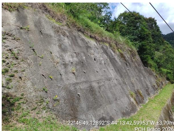
Figura 5-7 – Sistema de drenagem na PCH Braço.
