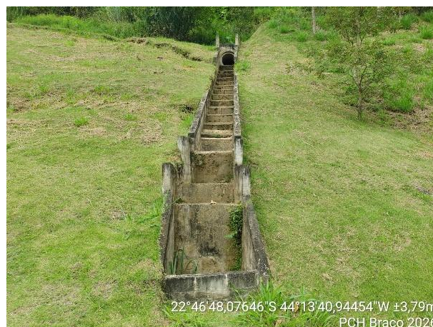
Figura 5-8 – Sistema de drenagem na PCH Braço.
